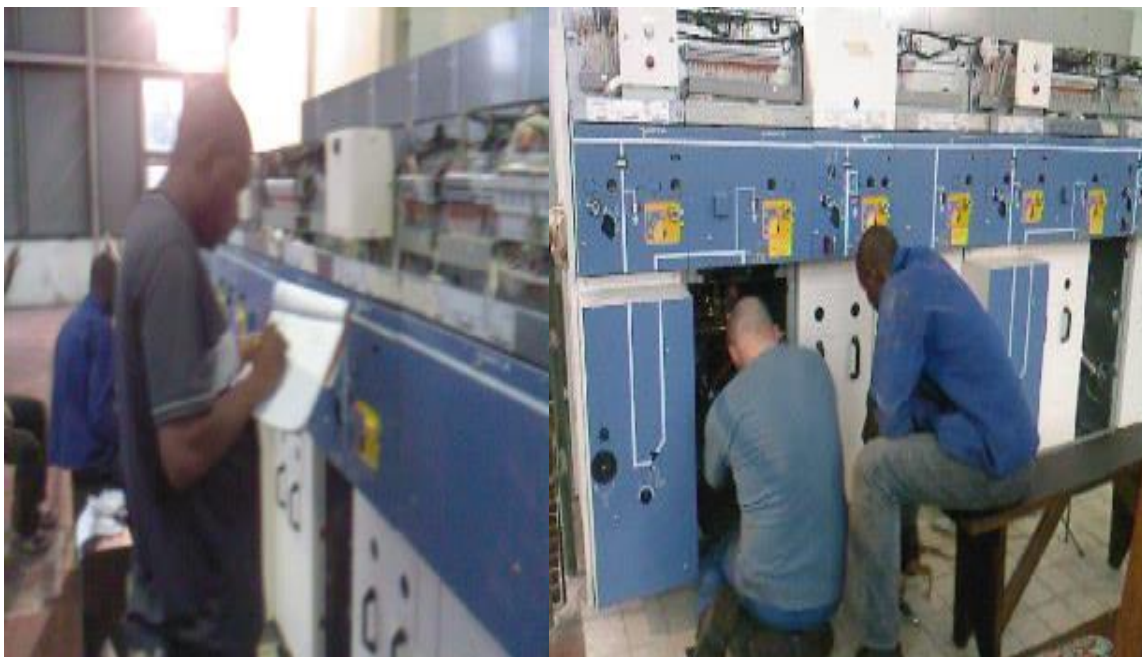
Deux apprentis en situation d'apprentissage auprès d'un expert de l'EDF à l'usine de Boali 2
